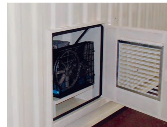
Alloggiamento compressore Air compressor room
